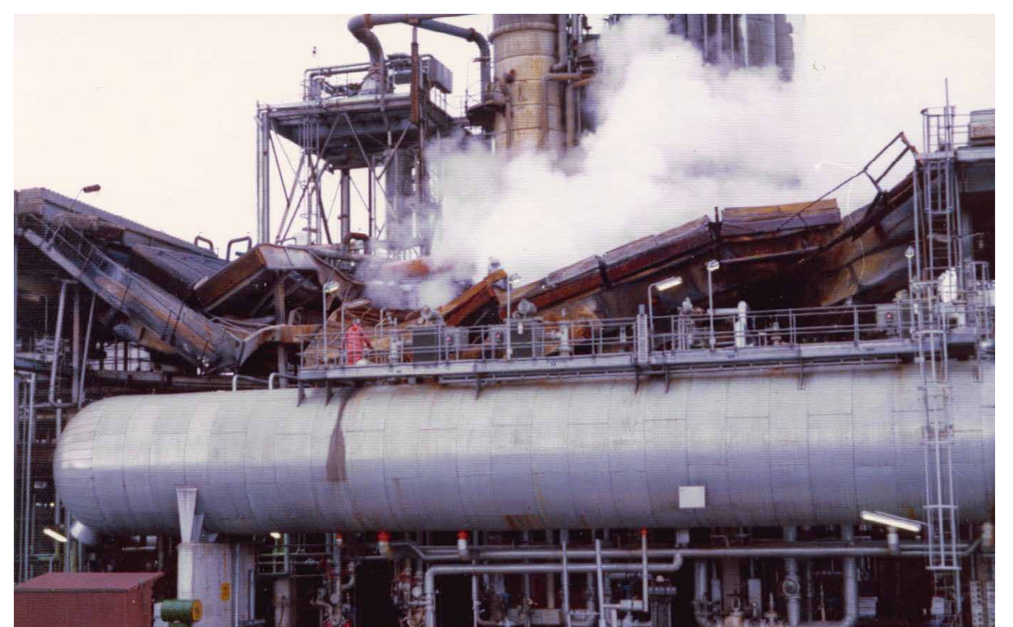
Viser skader i råoljeanlegg etter brannen
