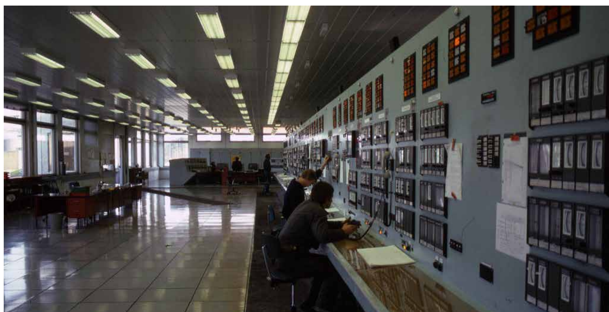
Kontrollrom ved oppstart
