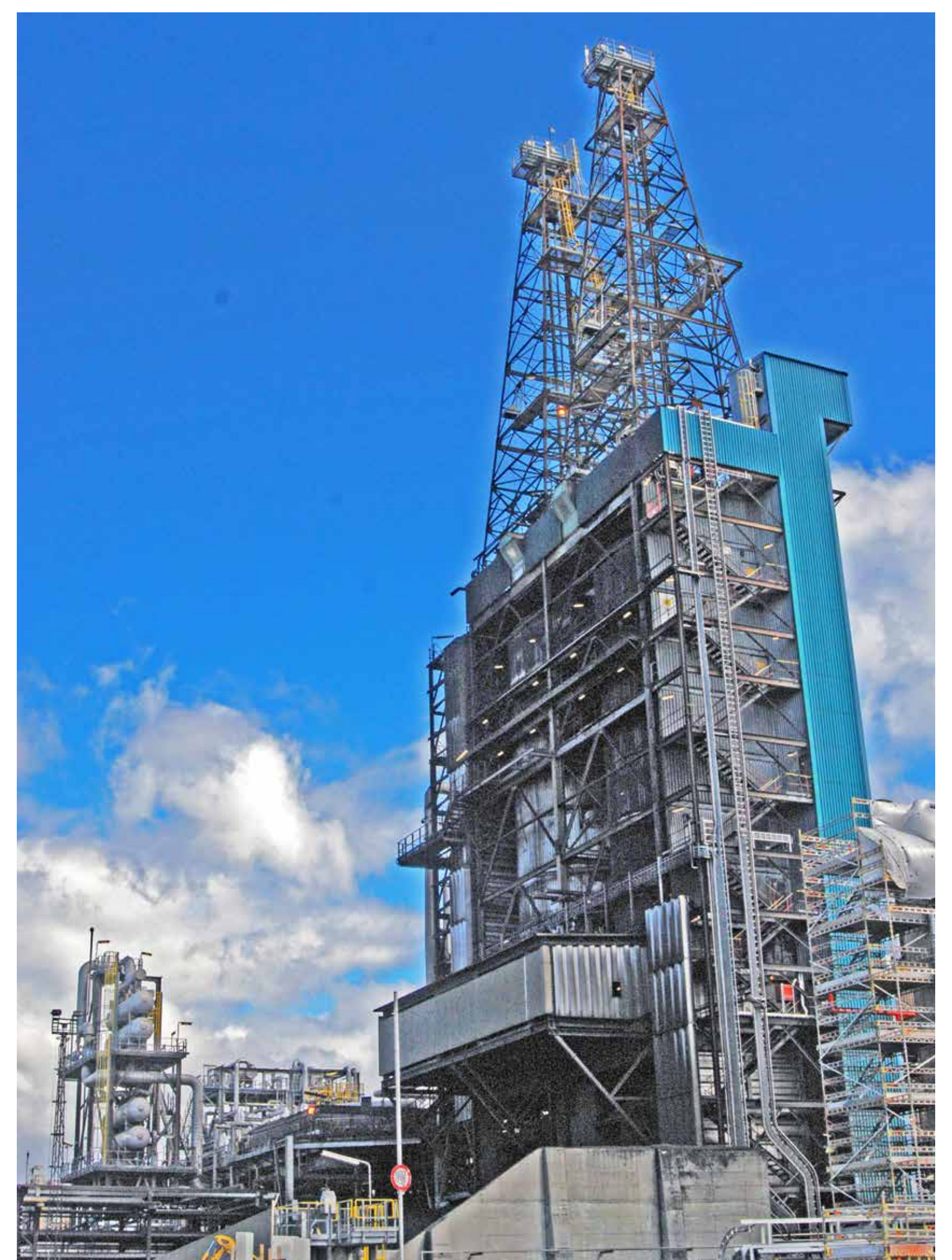
Koksanlegg (Koksbeholdere m/boretårn)
