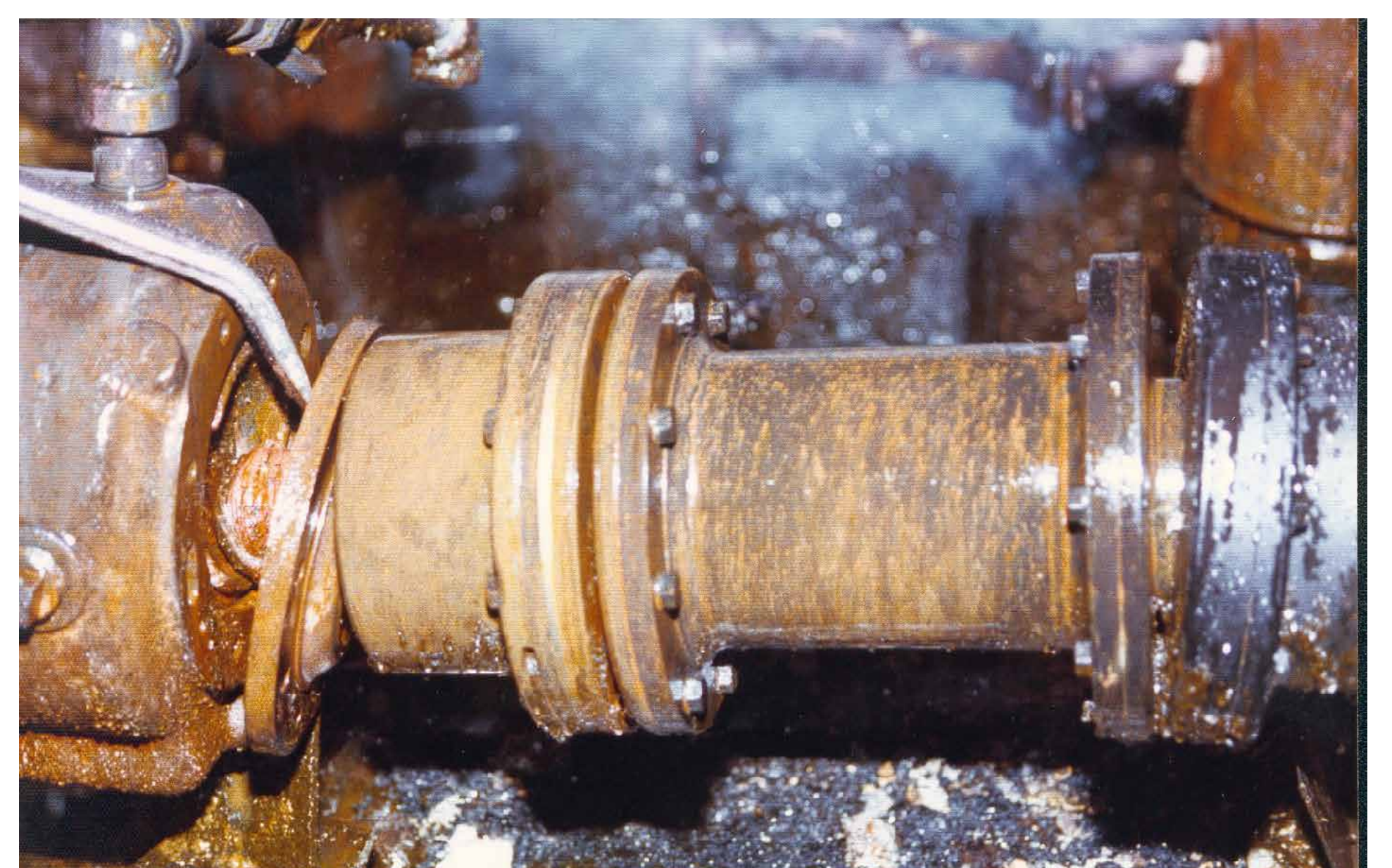
Akselbrudd på pumpe som forårsaket brannen
